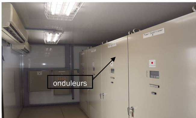
Salle de contrôle
